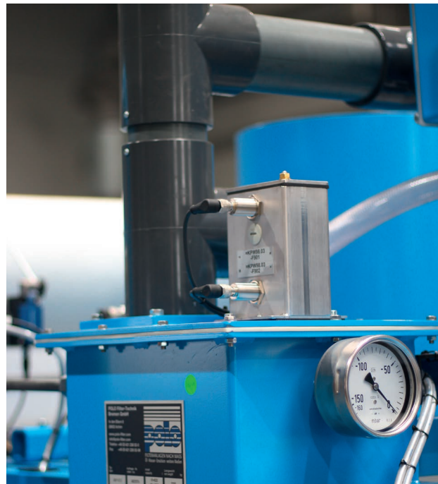
Vakuumturm / Vacuum tower
